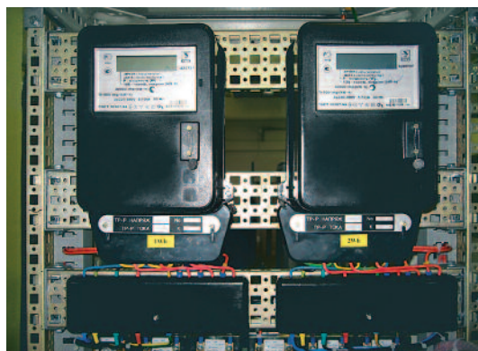
Блок учета электрической энергии
